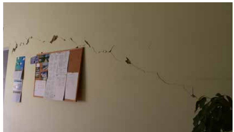
Tragovi potresa u ožujku 2020.
